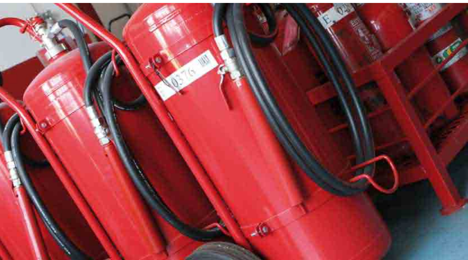
Figura 117 Deposito estintori carrellati
