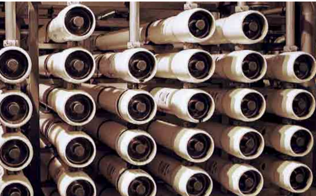
Figura 82 Foto impianto osmosi inversa
